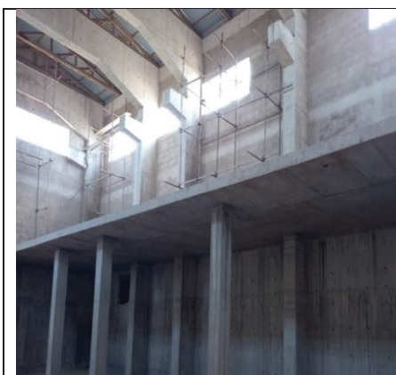
Picha namba 9-5: Eneo la Pampu ya Maji-Kisangara linaonesha eneo la wazi ambalo halijawekewa alama za zuio la kiusalama.
