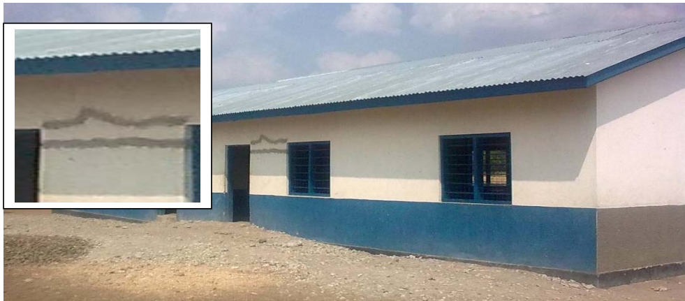
Madarasa mawili katika shule ya msingi Mwamala yaliyojengwa chini ya kiwango na nyufa hatarishi (horizontal cracks)
